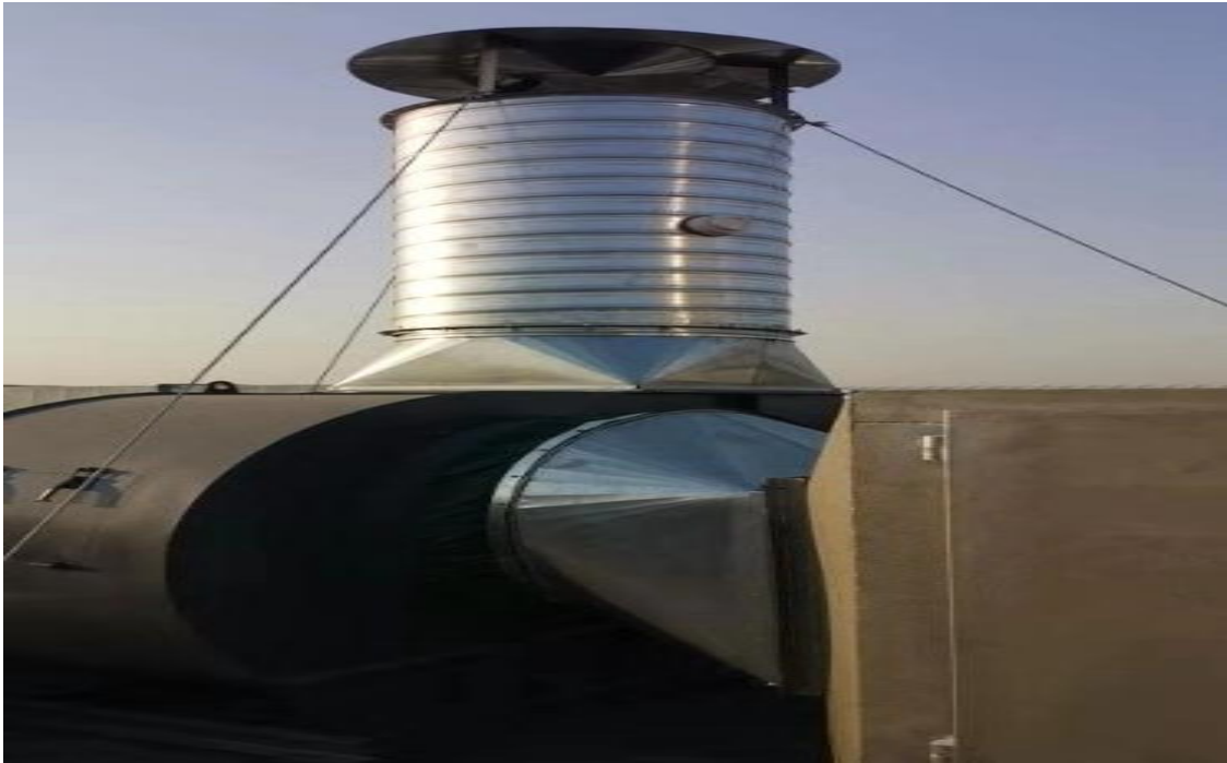
照片 4-4 有机废气排放口
