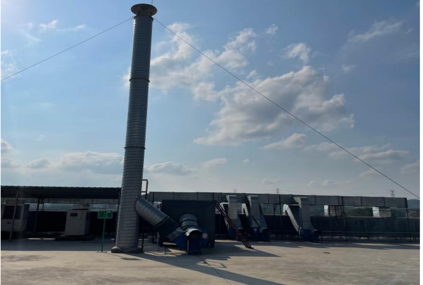
照片 4-4 熔化、搅拌、涂布、烘干工序废气排放口
